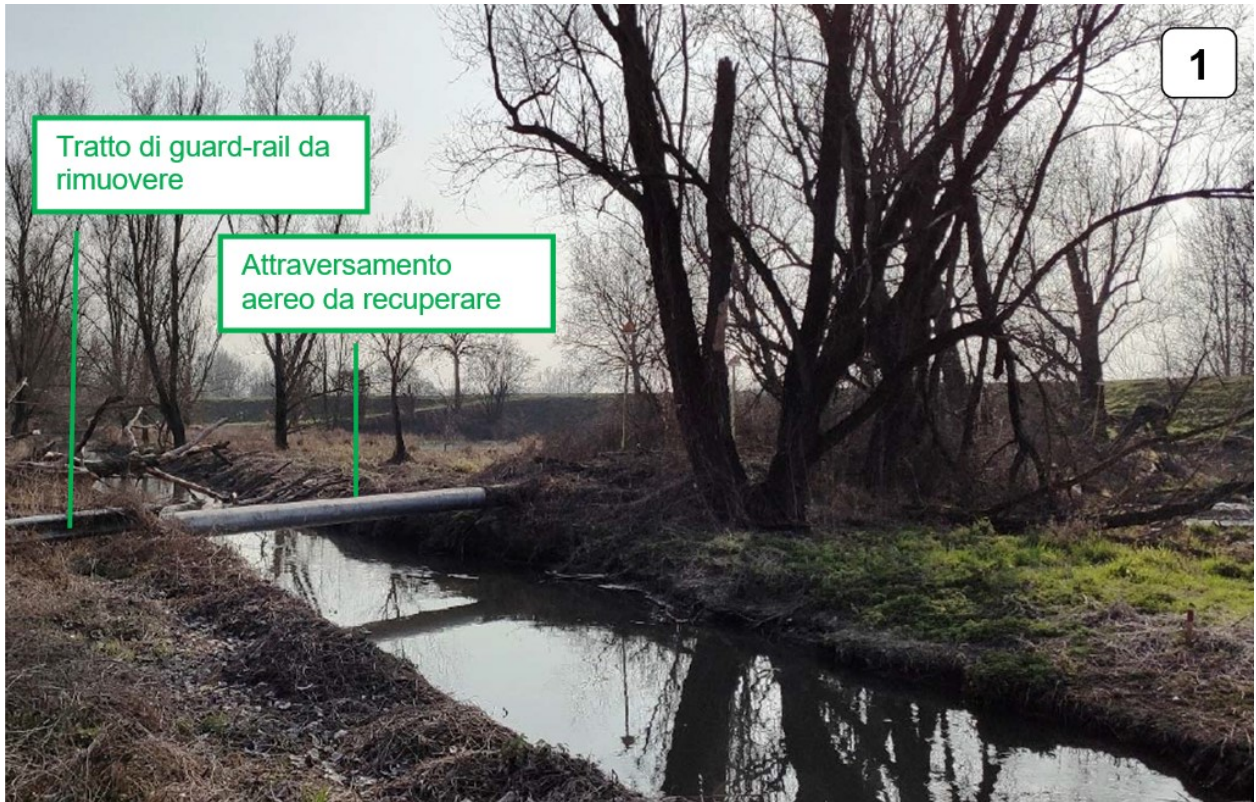
Foto 1 - Vista del tratto aereo da rimuovere, in attraversamento alla Roggia La Morta.
