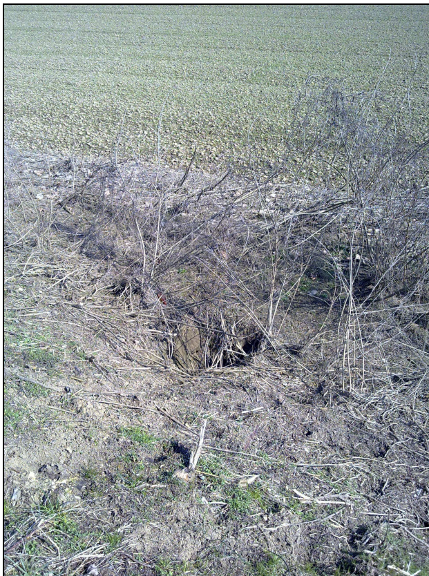
Foto 10: foro da erosione al piede dell'argine (lato fiume)
