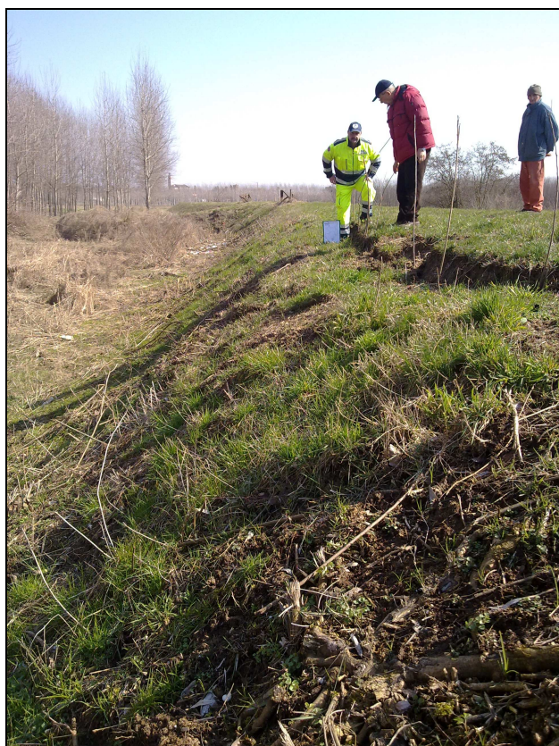
Foto 7: area più critica; possibile rigonfiamento?
