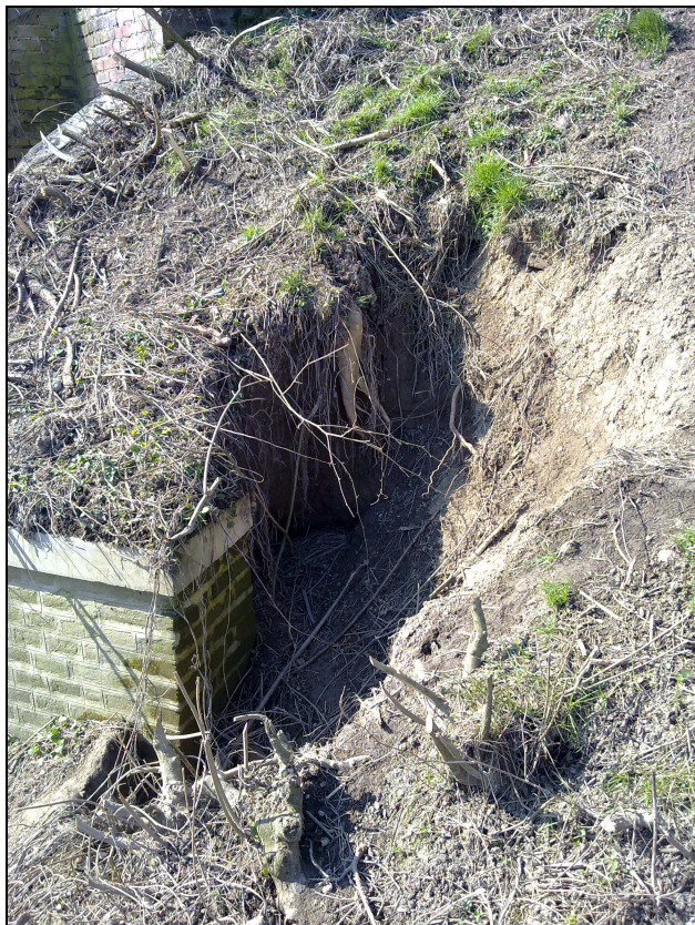
Foto 9: erosione sul lato N della chiavica (lato fiume)
