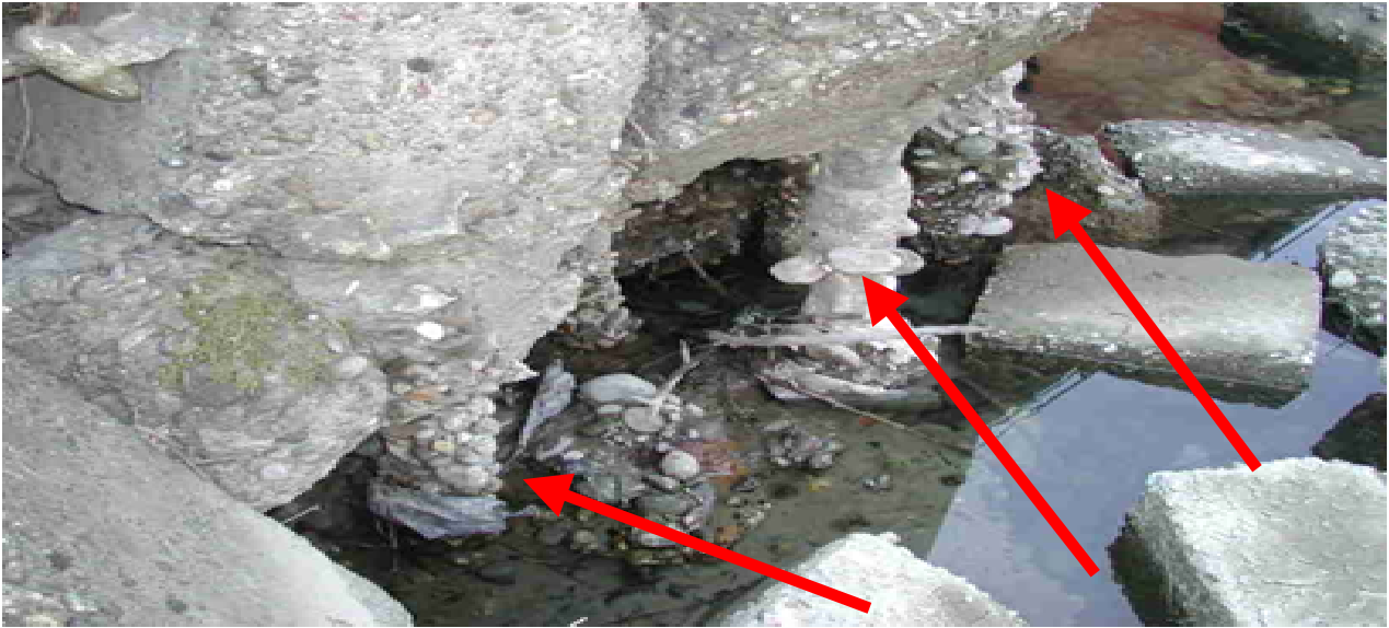
Erosione dei micropali eseguiti nei decenni precedenti
