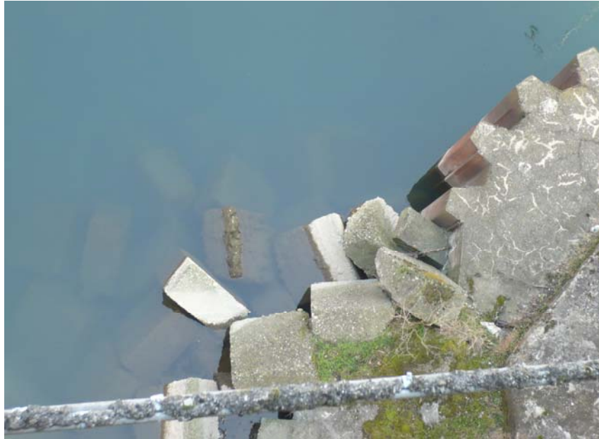
Fig. 2.2.9 – Massi ciclopici in calcestruzzo a difesa della base delle pile del ponte storico
