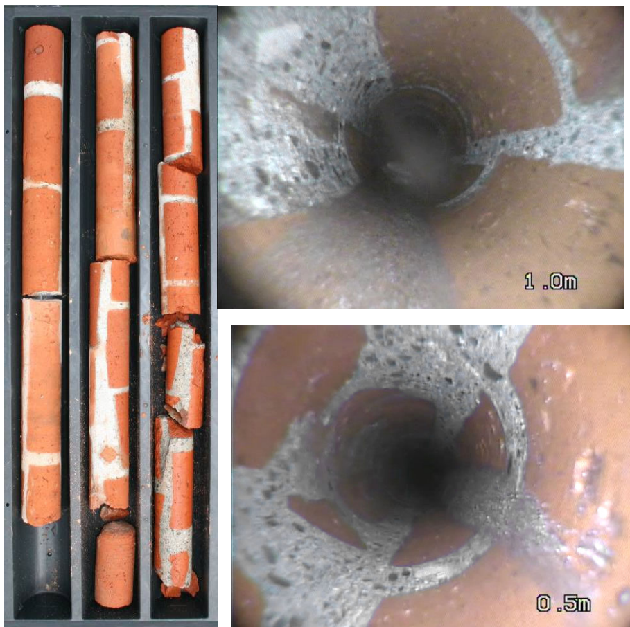
Figura 12. Tipologia della muratura in laterizio che costituisce il ponte. Campioni e riprese con sonda televisiva relativi al for C2..
