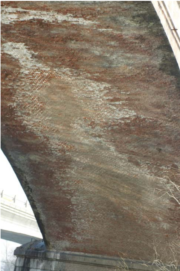
Fig. 2.2.5 – Stato della muratura in corrispondenza dell'arco.
