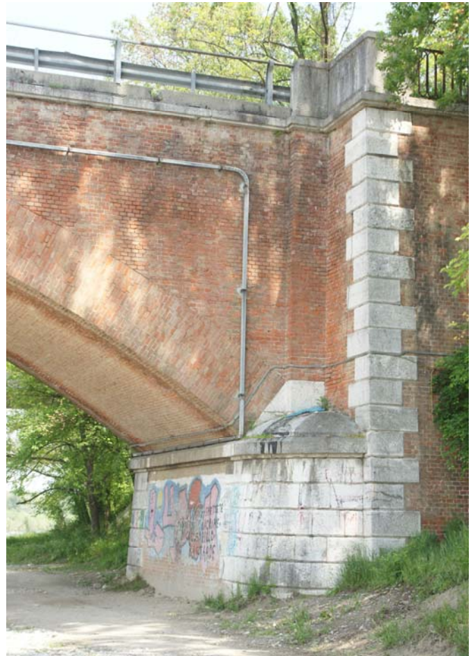
Fig. 2.2.6 – Stato della muratura in corrispondenza della spalla.
