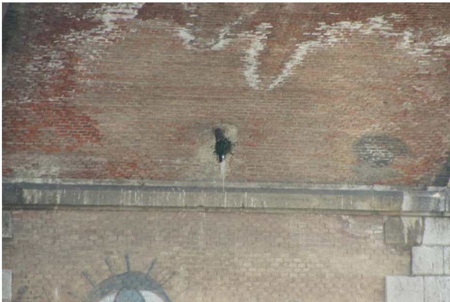
Fig. 2.2.4 – Doccione di scarico delle acque intasato.
