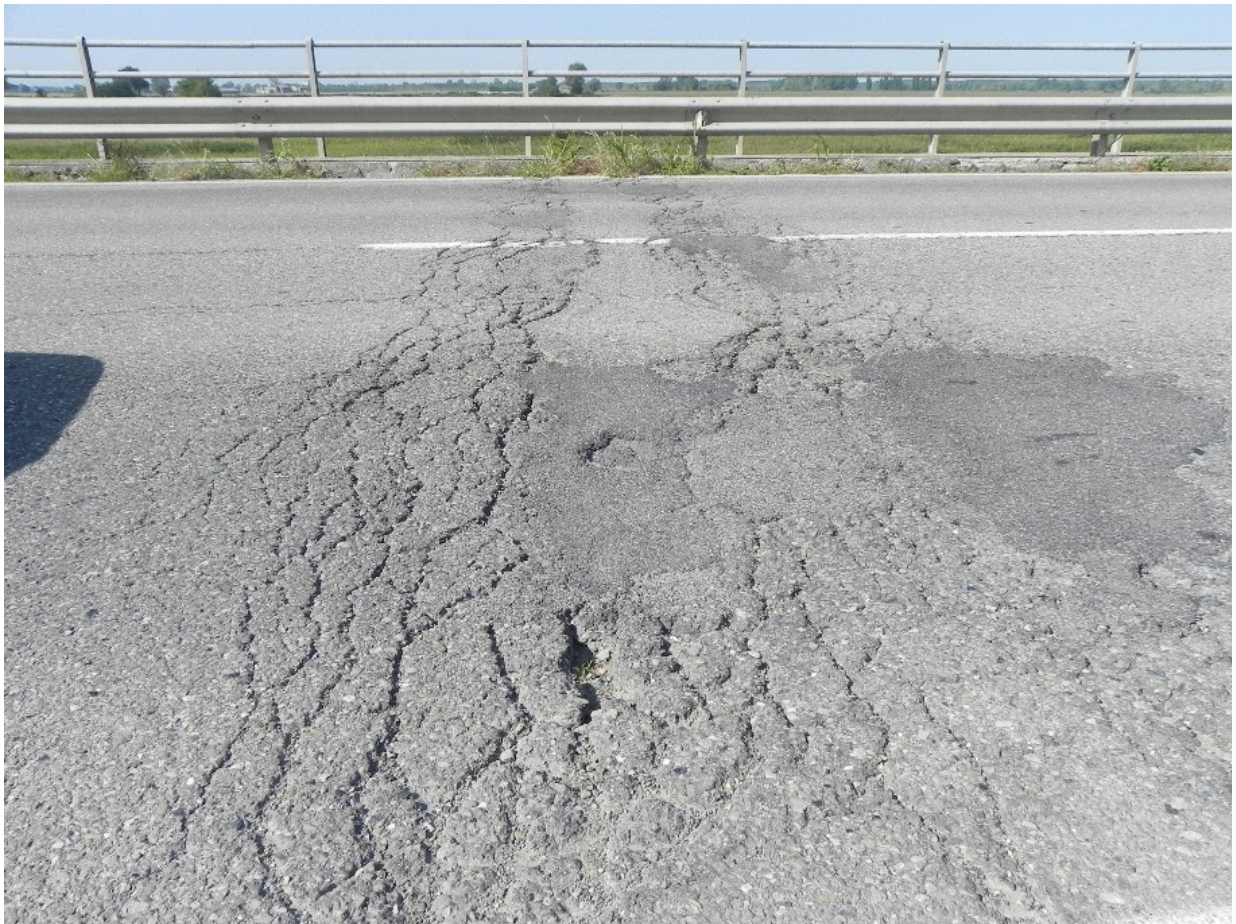
Fessurazione e sfondamento della pavimentazione in corrispondenza del giunto di dilatazione
